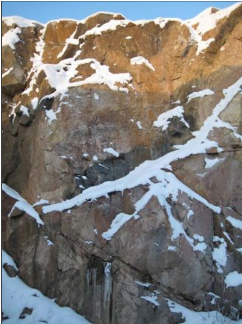
Kuva 11.1. Kalteva 40 cm leveä ruhje noin 15 metriä korkeassa kallioseinämässä (kuva n alaosassa). Ruhje on mittasuhteiltaan pieni, koska siitä tullut vesimäärä on hyvin vähäinen. Kallio on
