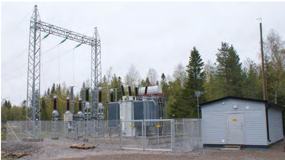
Figur 6-4 Exempel på en elstation.
