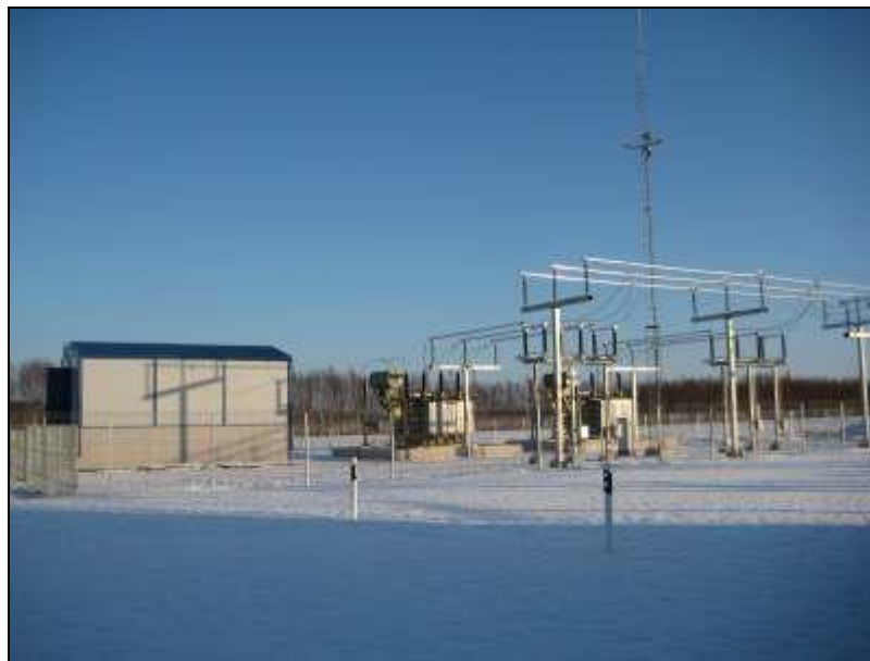
Kuva 3-11. Sähköasema (Kuva: Eltel Networks Oy).
