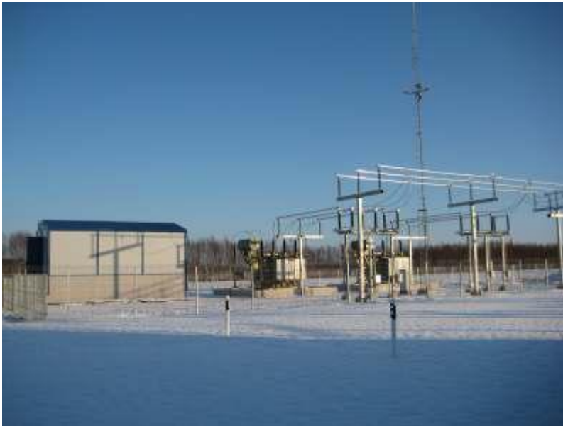
Kuva 3-11. Sähköasema (Kuva: Eltel Networks Oy).
