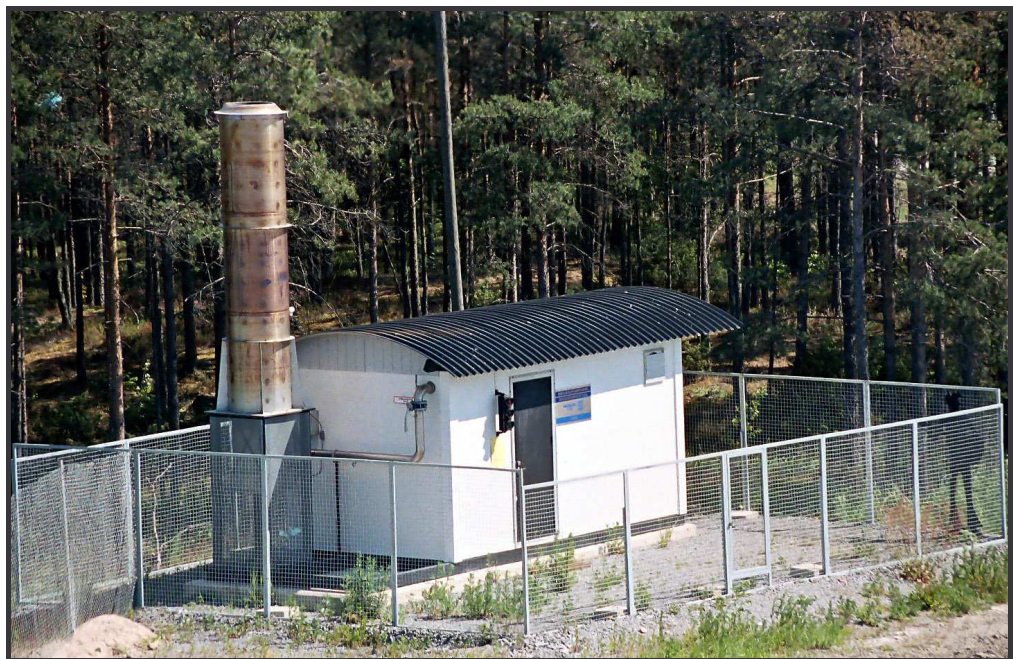
Kuva 15. Kaatopaikkakaasun pumppaamo ja soihutupoltin 21 .
