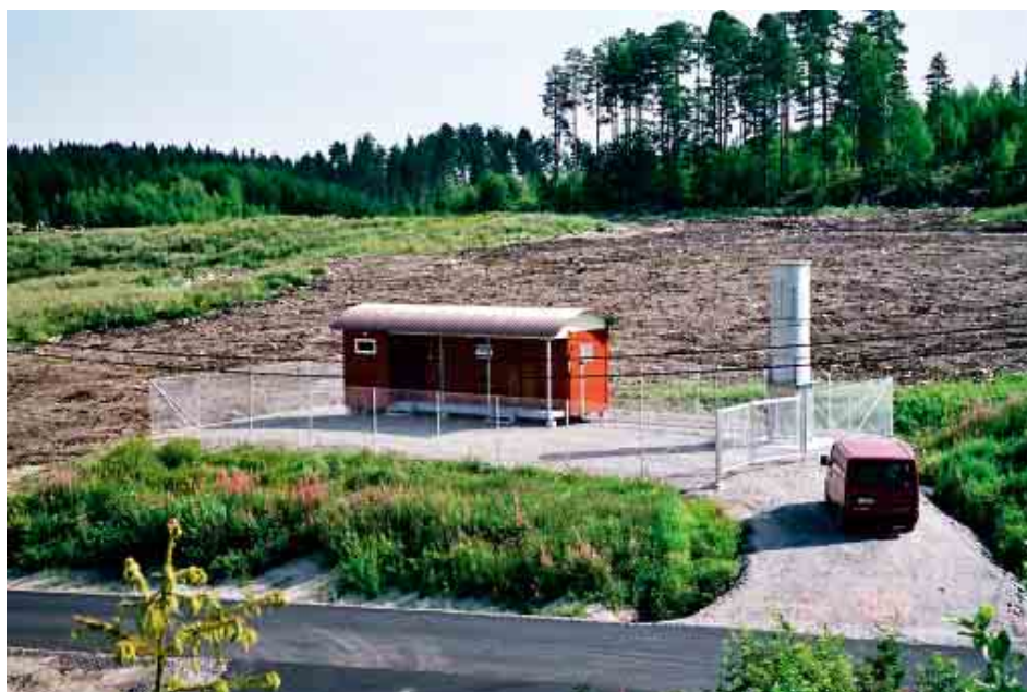
Kuva 3.21 Metsä-Sairilan kaasukeräysjärjestelmän kompressoriasema.
