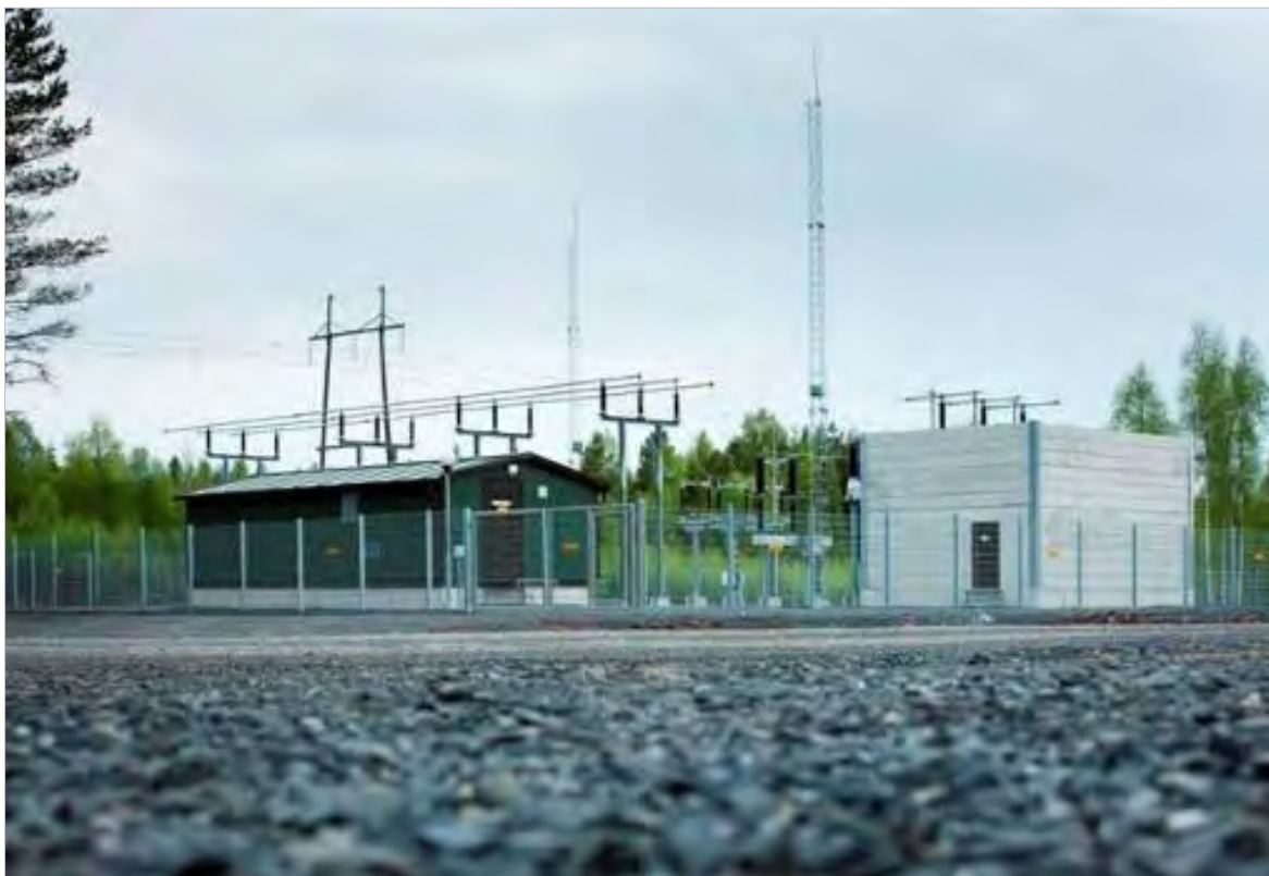
Kuva 21. Näkyvimvät komponentit sähköasemalla ovat suojarakennus, kytkinkenttä, ukkosmastot sekä muuntajabunkkeri (kuva VEO OY).
