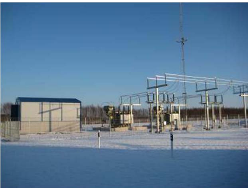
Kuva 16. Sähköasema (Kuva: Eltel Networks Oy)
