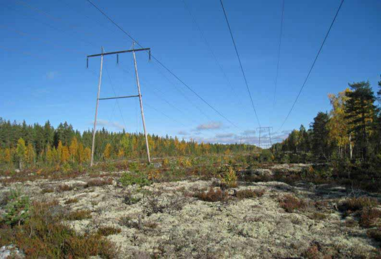
Kuva 6-1. Fingridin voimajohtoalue Pesuankalliolla.
