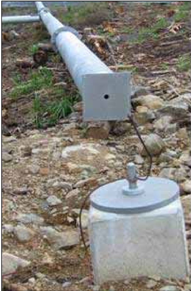
Kuva 8. Pylväsjalan perustus ja maadoituselektrodijohdin.
