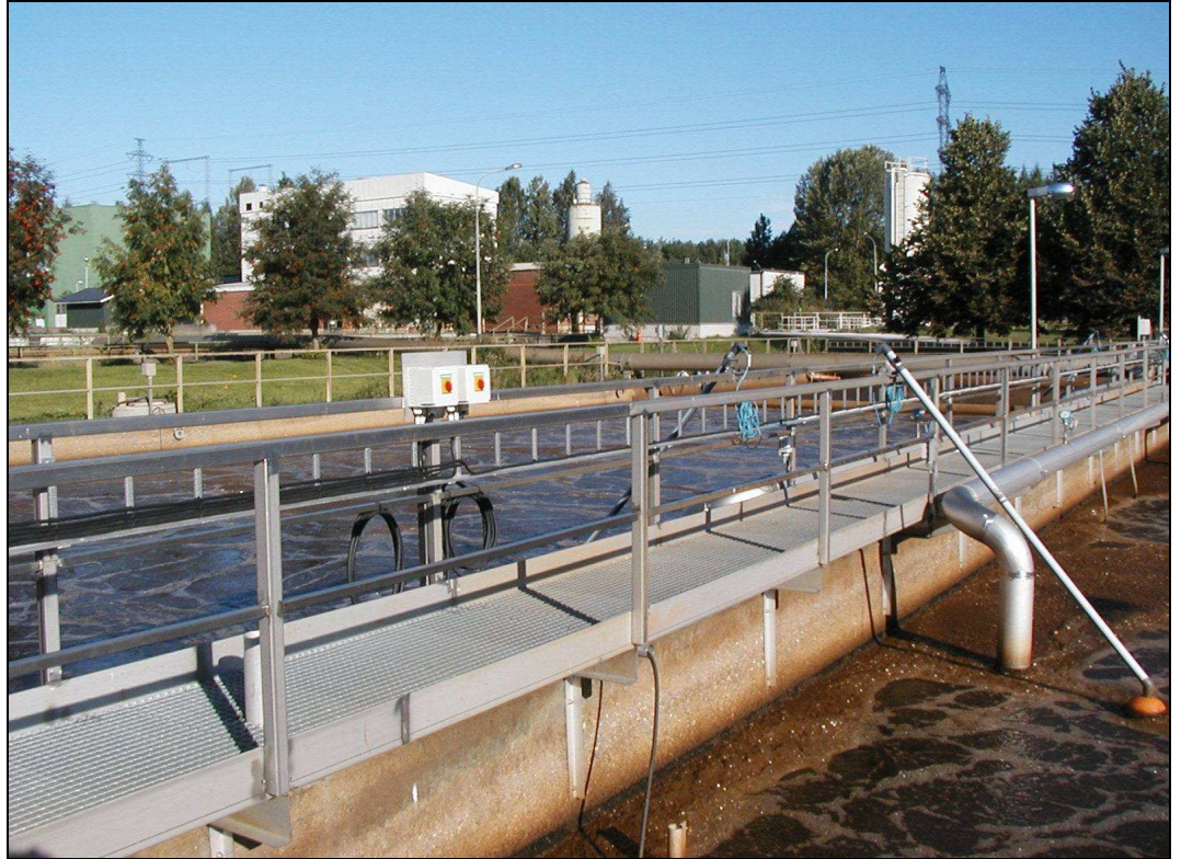
Kuva 15. Toikansuon puhdistamon ilmastusaltaat.
