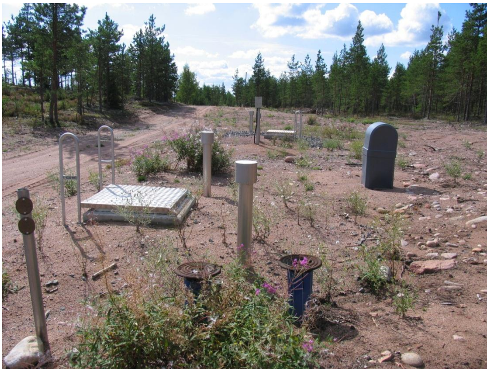
Kuva 5-1 Kaksi vierekkäin olevaa siiviläputkikaivoa. (Kuva: Jukka Ikäheimo)
