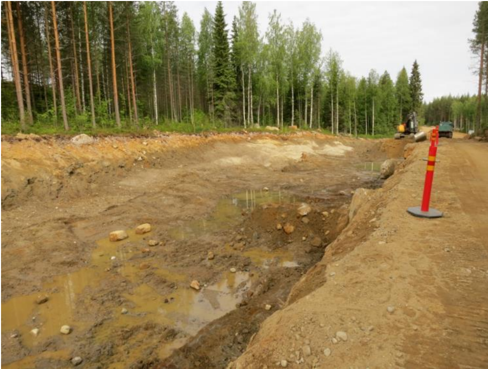
Kuva 10.1. Voimatien uuden linjauksen työmaa on paljastunut kallion suunnitellun biohiiltämön länsireunalla. Kallion päällä on vettäpidättävä harmaa hiesu-savikerros ja päällimmäisenä kivinen hiekkamoreeni. Kuvaussuunta on luoteeseen.
