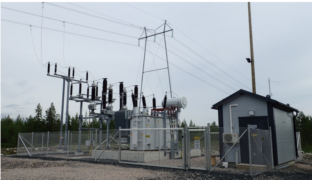
Kuva 5.8. Esimerkki tuulivoimapuiston sähköasemasta (Minna Takalo, FCG).
