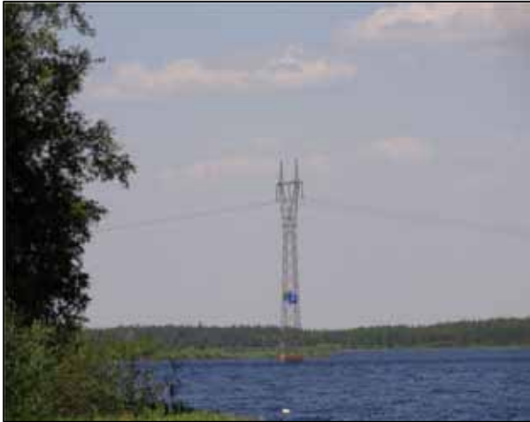
Kuva 107. Nykyinen vesistöpylväs Uljuan tekojärven rannalla.
