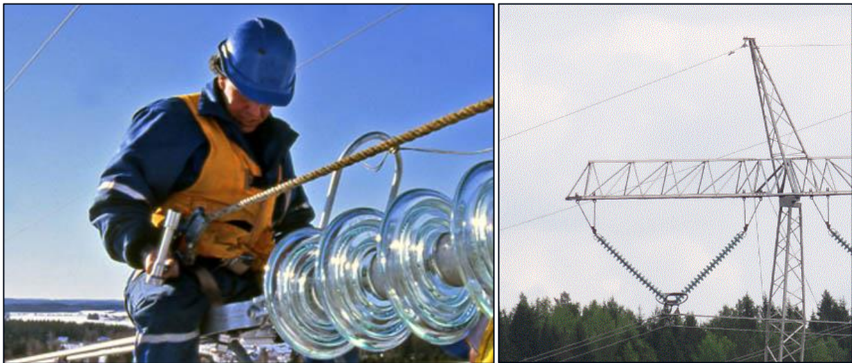
Kuva 6.3. Voimajohtopylvään eristimiä, joissa koronapurkauksia voi esiintyä.
