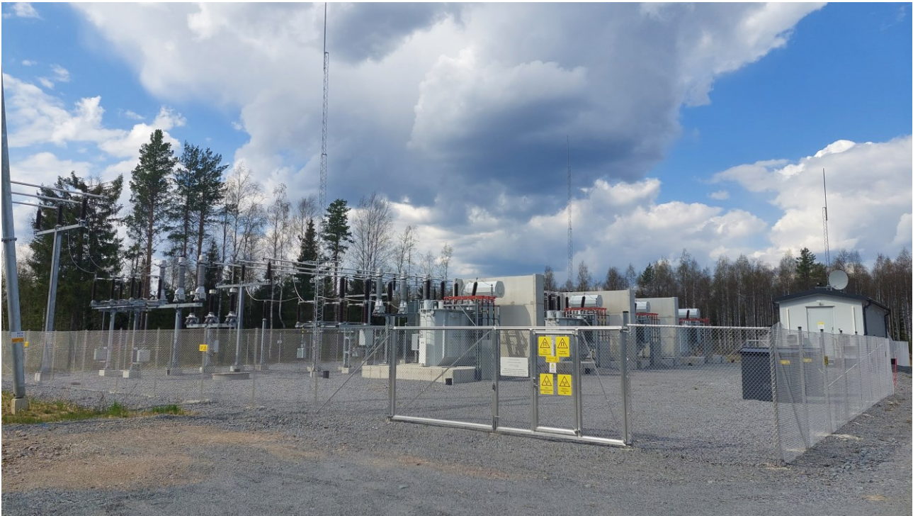
Kuva 20. Esimerkki tuulivoimapuiston sähköasemasta (Välkankaan tuulipuisto, Haapajärvi).
