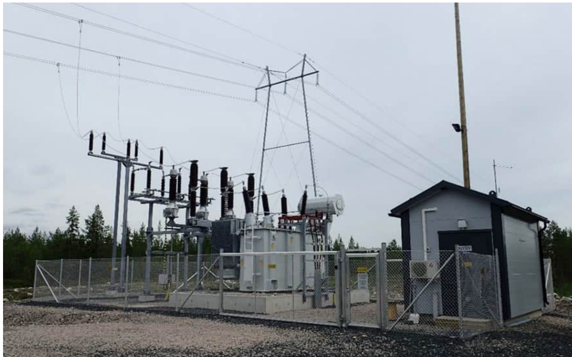
Kuva 4.9. Esimerkki tuulivoimapuiston sähköasemasta.
