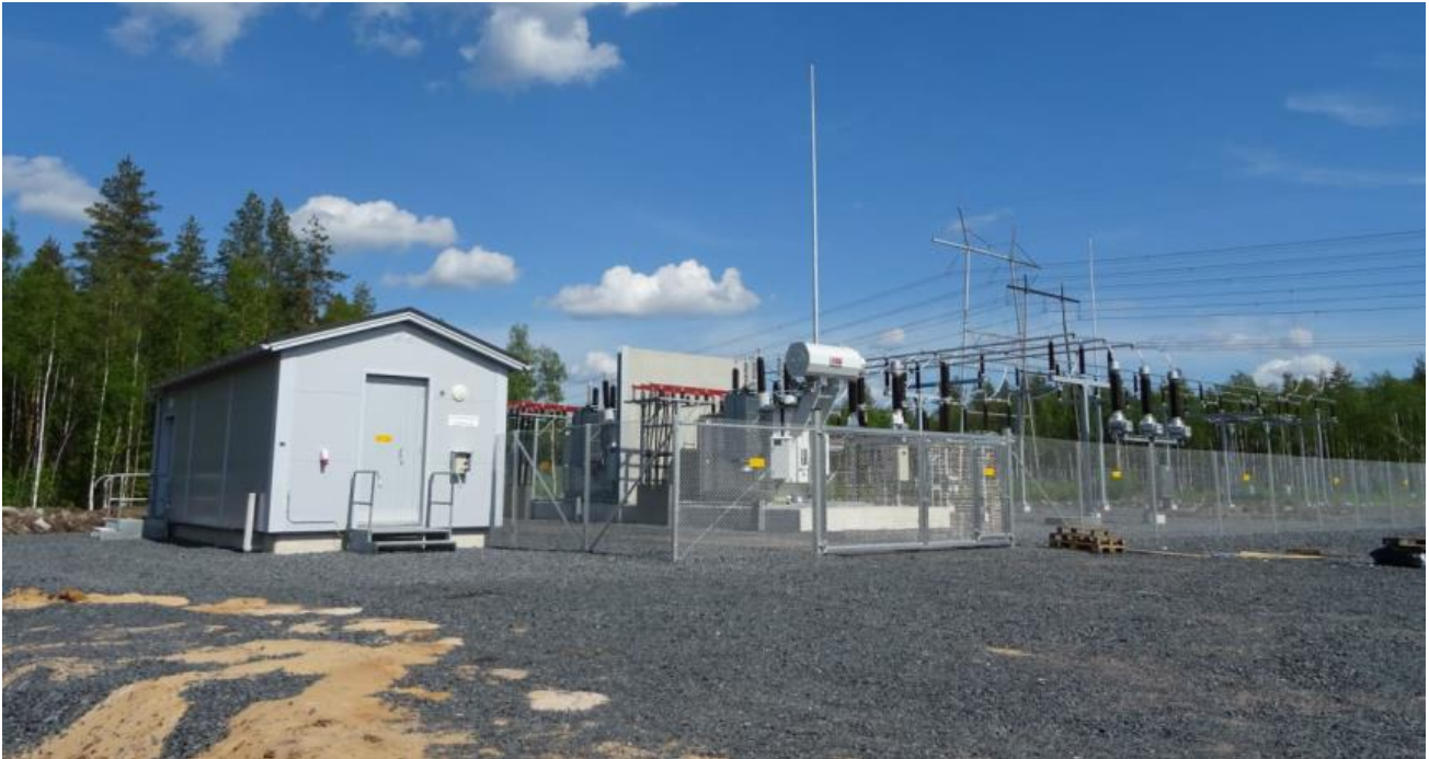
Kuva 10. Esimerkki tuulivoimapuiston sähköasemasta (Oltava, Pyhäjoki) (Kuva: Sweco Finland Oy).
