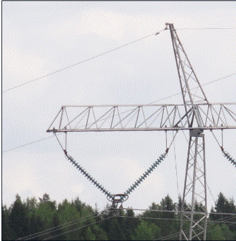
Kuva 5-17. Voimajohtopylvään eristimiä, joissa koronapurkauksia voi esiintyä.
