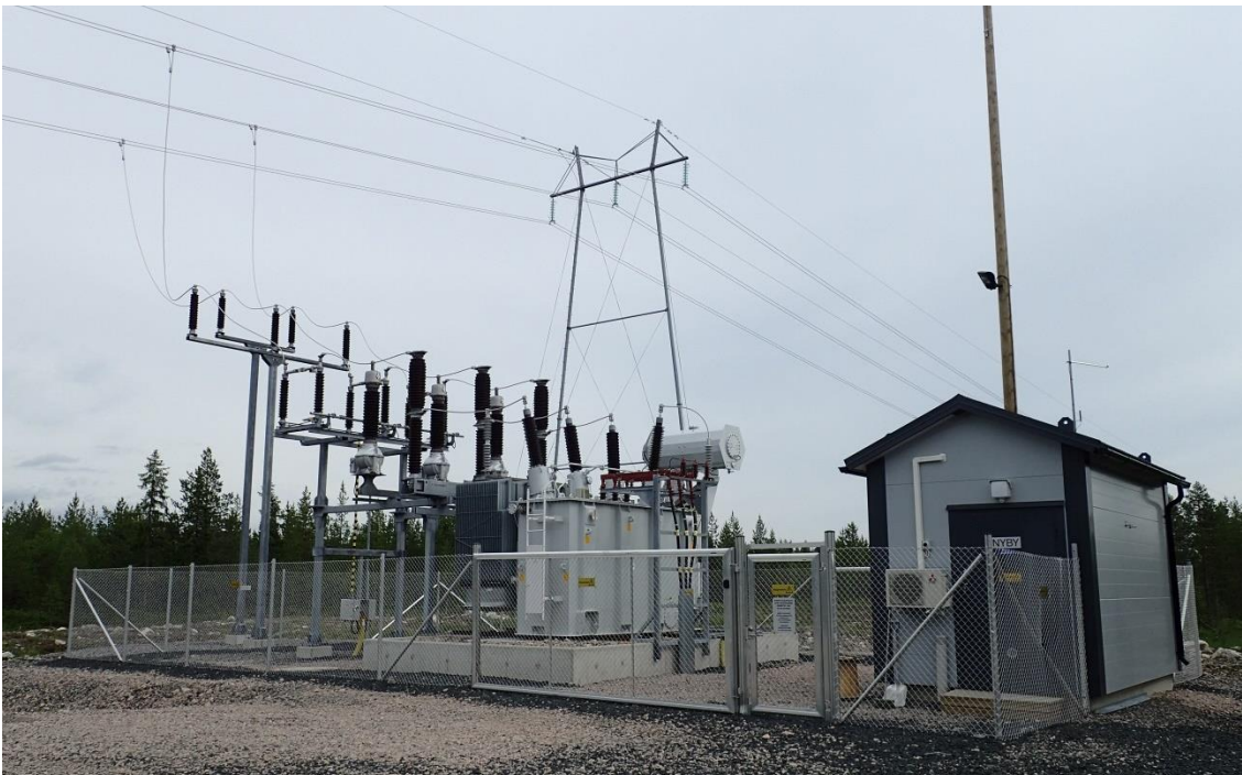
Kuva 5.7. Esimerkki tuulivoimapuiston sähköasemasta. (Kuva: Minna Takalo / FCG).
