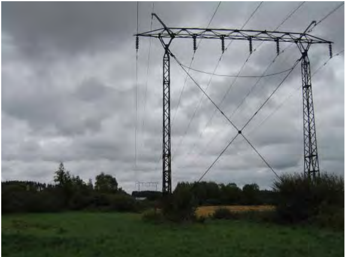
Kuva 31. Nykyinen 2 x 110 kV voimajohtopylväs visuaalisella vyöhykkeellä 1.
