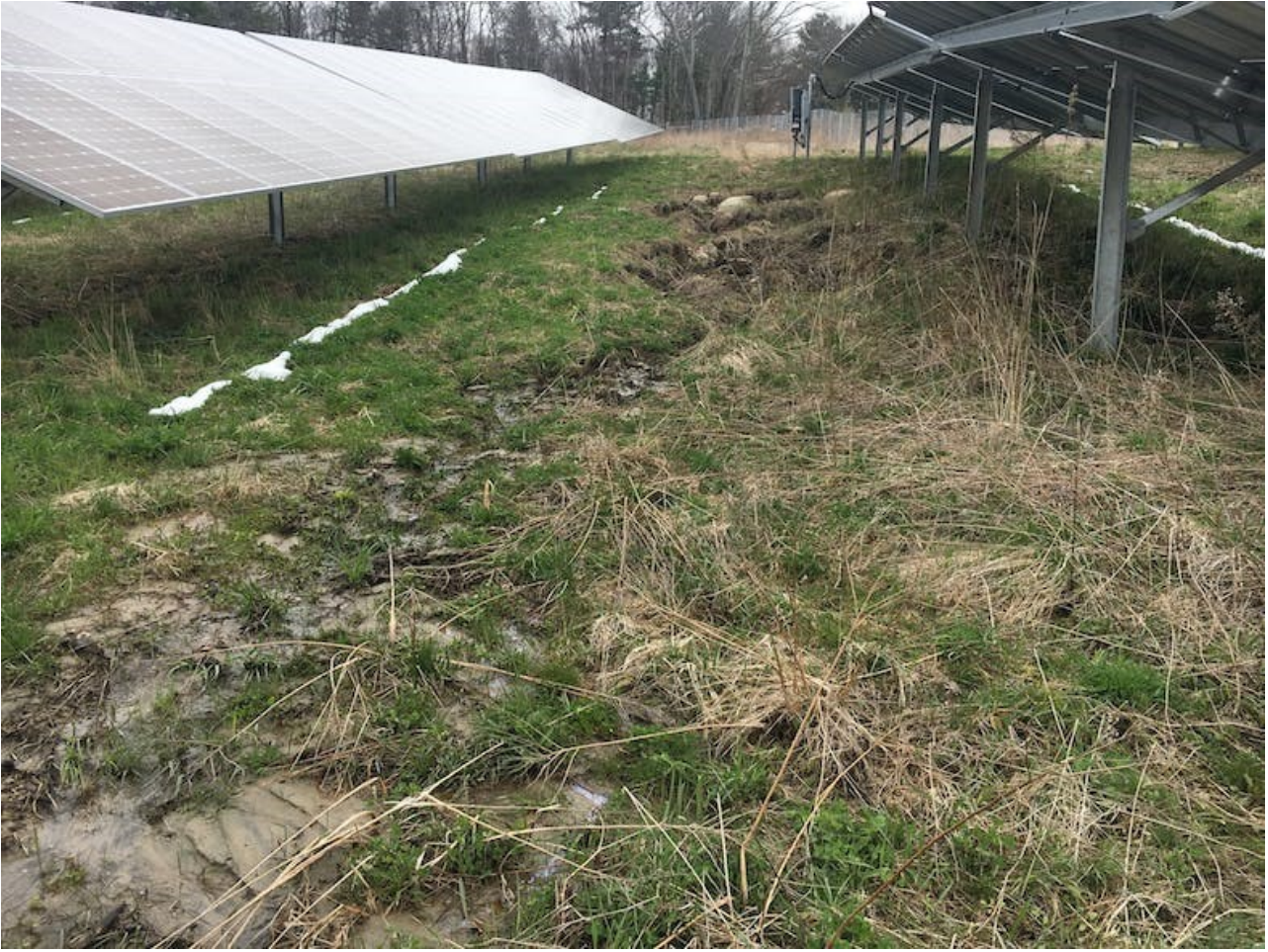
Kuva 169. Eroosiohaittoja aurinkopaneelien välissä savimaalla. (Kuva: https://www.stormwater.com/home/article/21148549/solar-and-stormwater )
