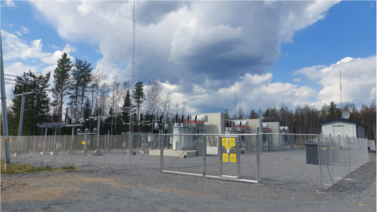
Kuva 25. Esimerkki tuulivoimapuiston sähköasemasta (Välikankaan tuulipuisto, Haapajärvi).
