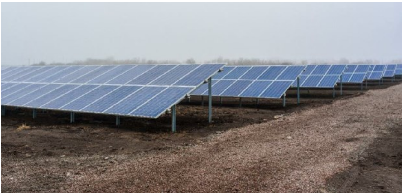
Kuva 16. Esimerkkikuva aurinkopaneeleista (Windfarm Palloneva Oy).
