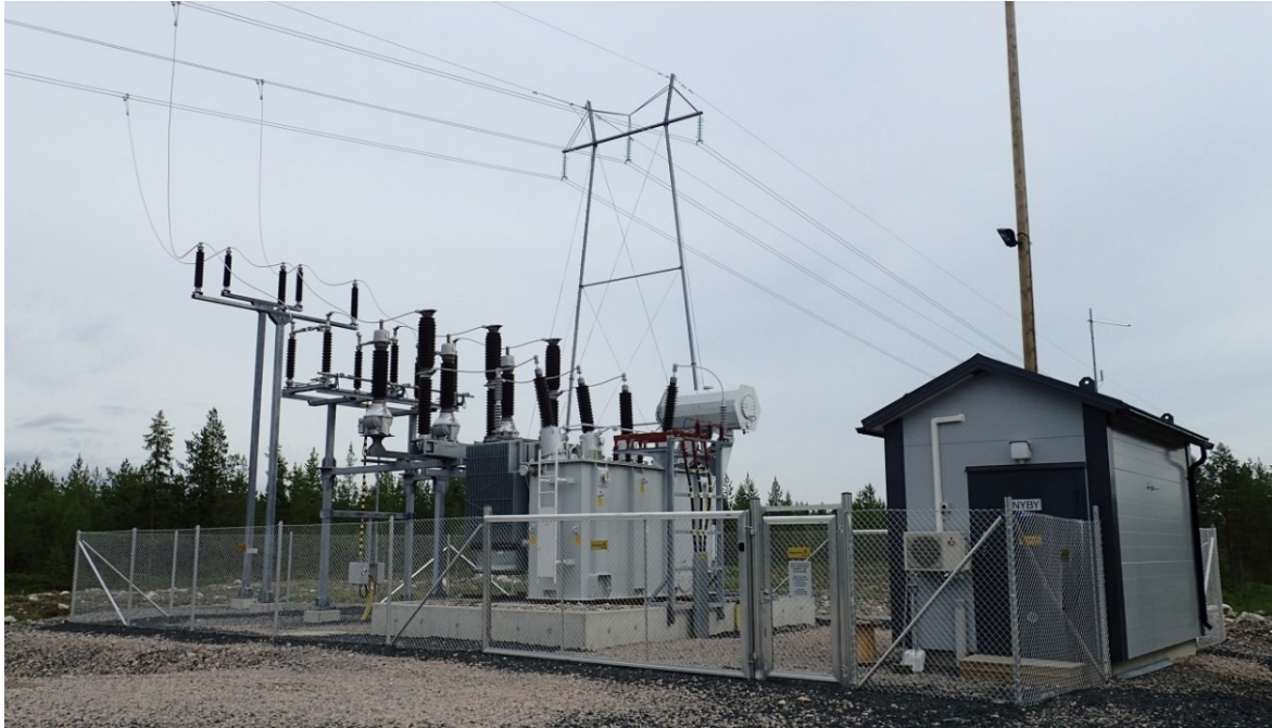
Kuva 5.8 Esimerkki tuulivoimapuiston sähköasemasta (FCG).
