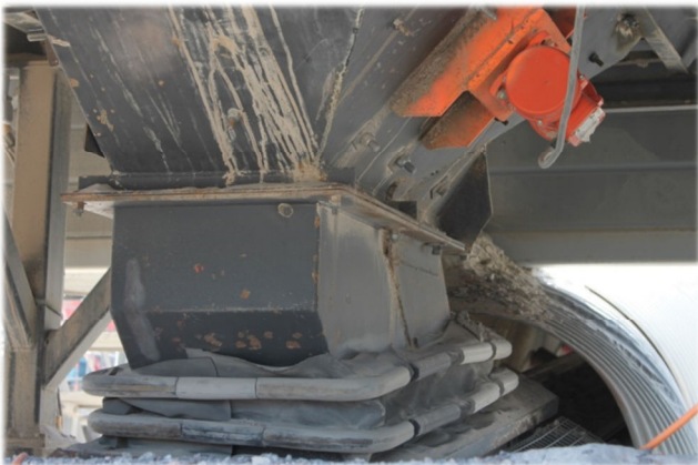
Kuva 15. Alitteen putoamiskohdan suojaus kuljettimelle.
