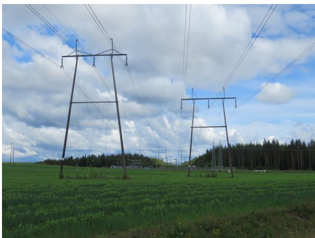
Kuva 32. Linja Uvan sähköaseman (taustalla) kohdalla.
