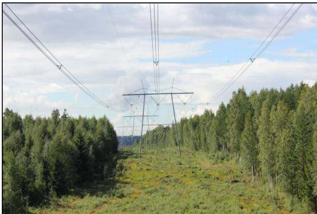
Kuva 22. Hankealueen länsipuolella sijaitseva 400 kV suurjännitelinja. Hankealue rajautuu kuvan vasemmalle puolelle.
