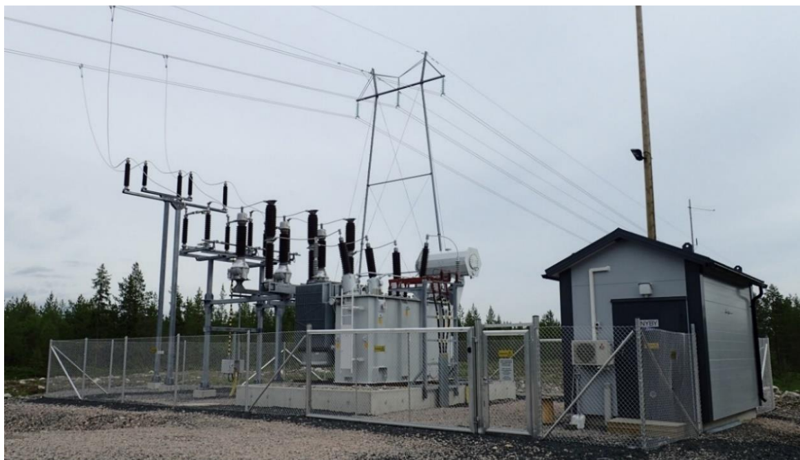
Bild 5.8 Exempel på en vindkraftsparks elstation (FCG Finnish Consulting Group Oy).
