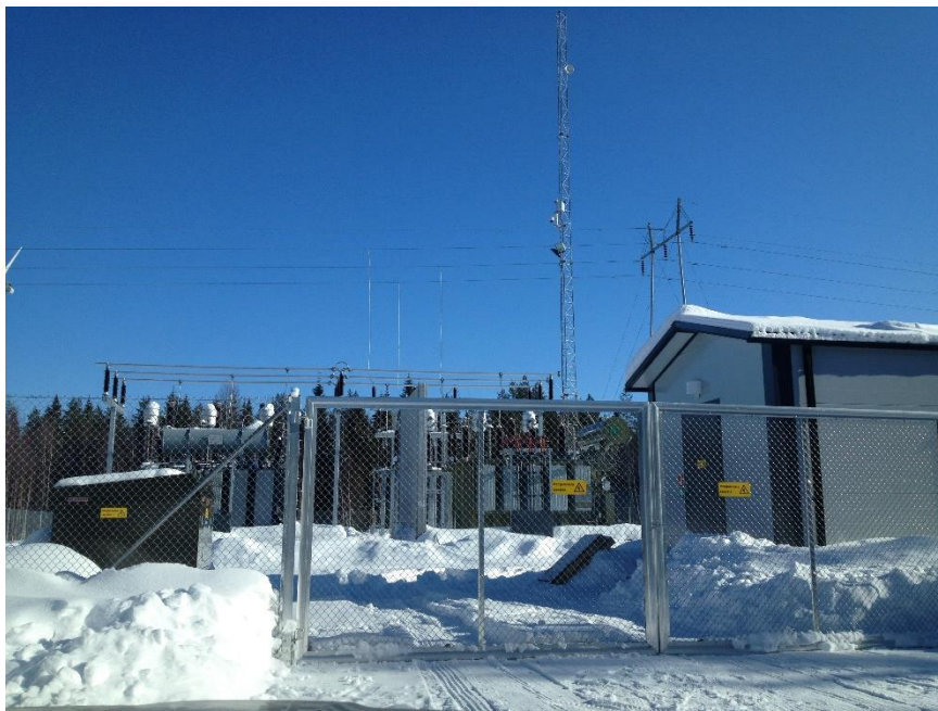
Kuva 3-16 Tuulivoimapuiston sähköasema. © Metsähallitus.
