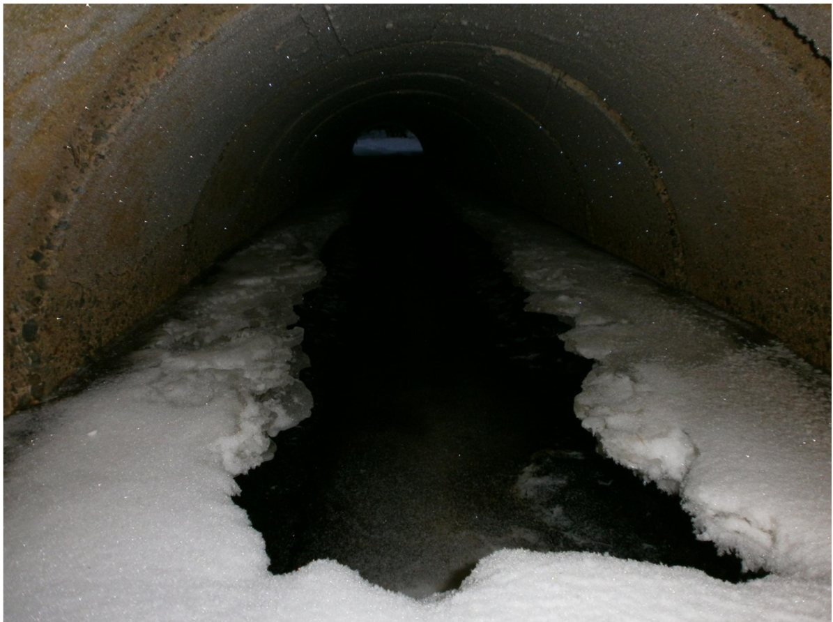
Kuva 100. Saukko pääsee tarvittaessa alittamaan Uttermossantien betonisessa rumpuputkessa.
