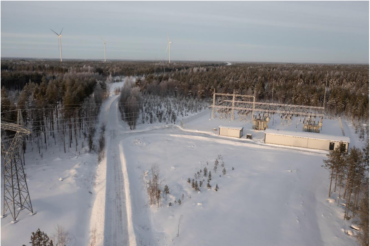
Kuva 3-4. Esimerkki tuulivoimahankkeen sähköasemasta (valokuva: Petteri Löppönen, OX2)
