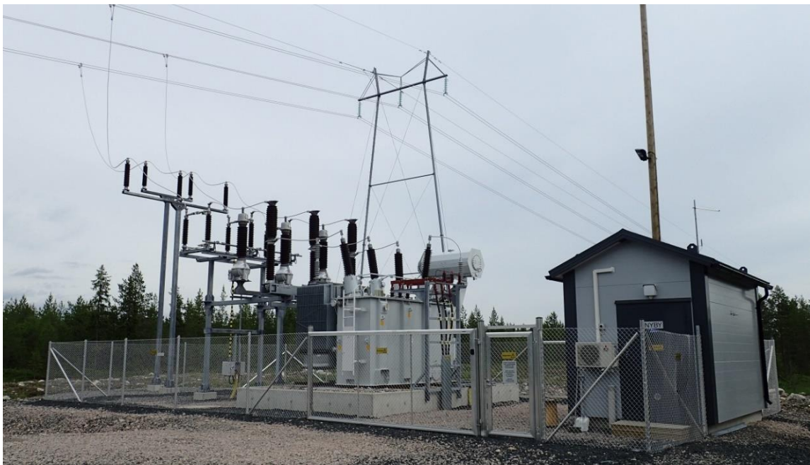
Kuva 5-8. Esimerkki tuulivoimapuiston sähköasemasta (Minna Takalo, FCG).
