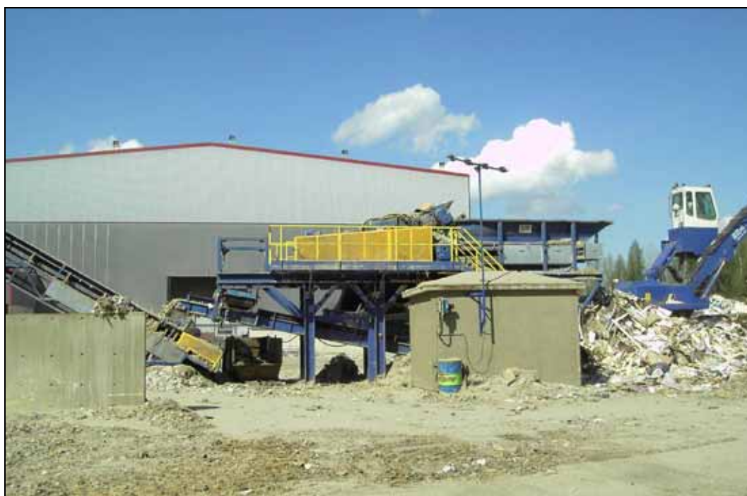
Kuva 7. Kierrätyspolttoaineen murskauslaitteisto (valokuva: Ossi Sippola/ Toivonen Yhtiöt Oy 2005).
