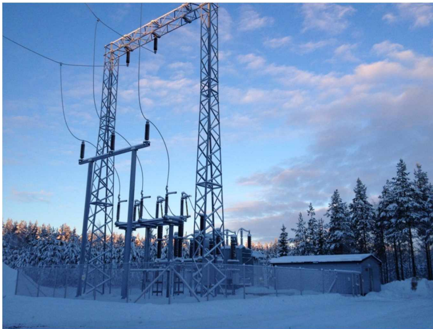
Kuva 4. Tuulipuiston sähköasema. Kuva Tuulimuukon asemasta Lappeenrannassa (Abb Oy).
