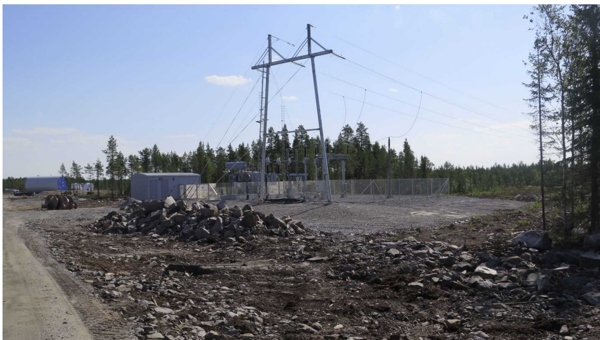
Kuva 5. Tuulipuiston sähköasema. Kuva Mäkikankaan tuulipuiston sähköasemasta Pyhäjoelta © wpd Finland Oy.
