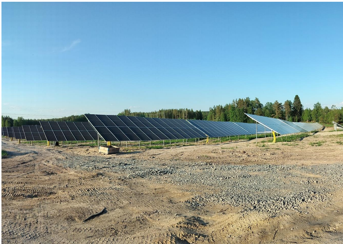
Kuva 5.11 Esimerkki rakenteilla olevasta aurinkovoima-alueesta. Kuvassa Kitusenkulman aurinkovoima-alue Virroilla. (Kuva: FCG)
