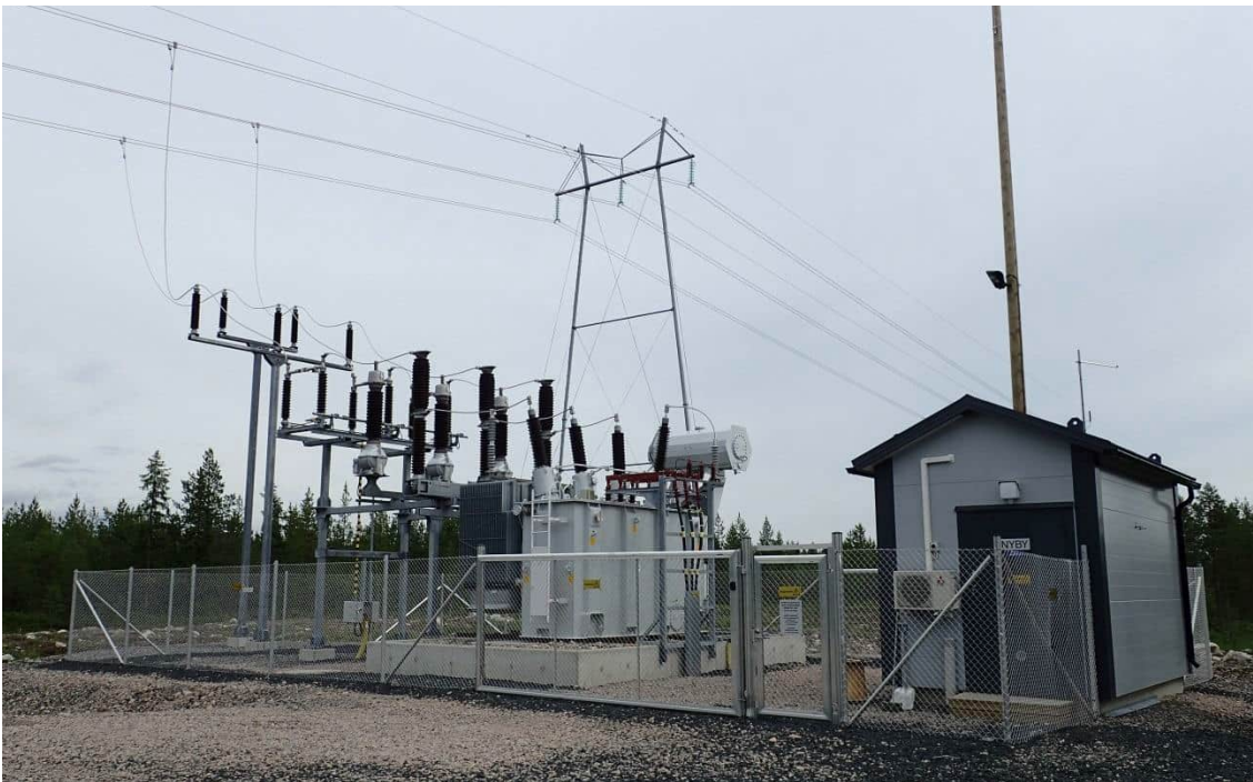
Kuva 4.2.1. Esimerkki tuulivoimapuiston sähköasemasta (Kuva: FCG).
