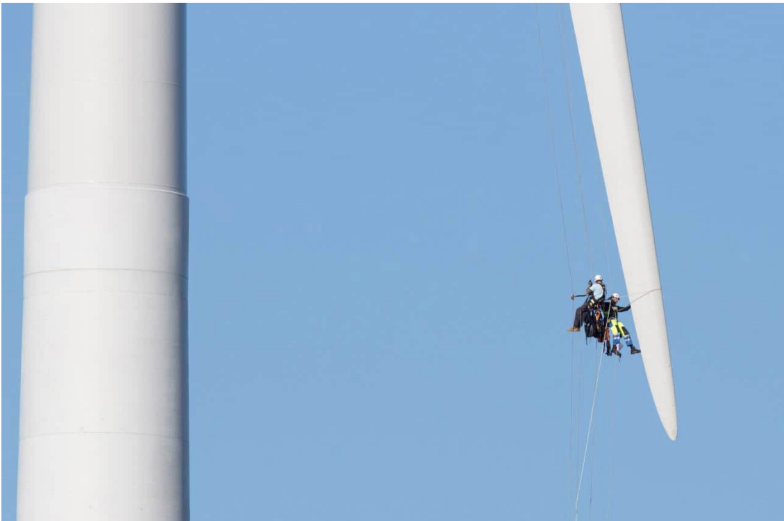
Kuva 4.4.1. Tuulivoimalan huoltotoimenpiteitä. (Kuva: FCG).
