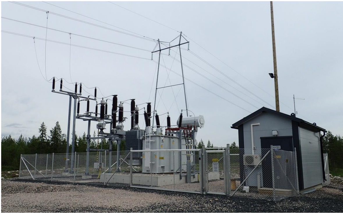
Kuva 4.9 Esimerkki tuulivoimapuiston sähköasemasta (FCG Finnish Consulting Group Oy).
