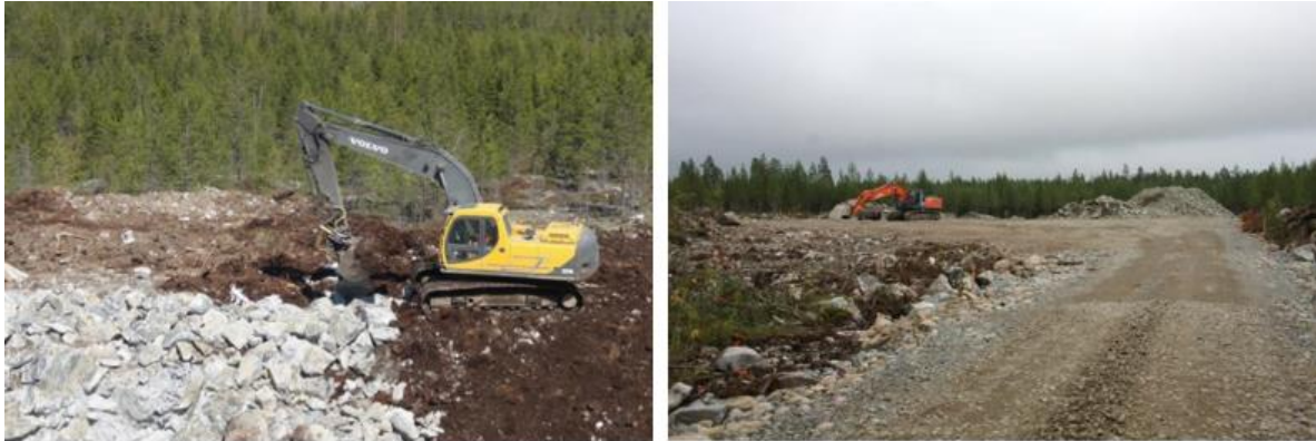
Kuva 4.12 Tuulivoimapuiston rakentaminen alkaa huoltoteiden ja pystytysalueiden rakentamisella (FCG Finnish Consulting Group Oy).
