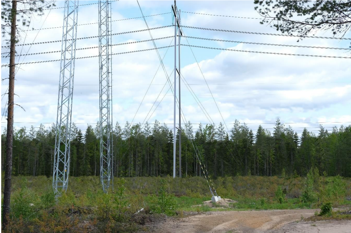
Kuva 8.39. Sähkösiirtoreitin havainnekuva Korkattivuorelta. Kuvassa näkyy etualalla (kuvassa vasemmanpuoleinen pylväs) nykyiset voimajohdot ja taka-alalla (kuvassa keskellä oleva pylväs) suunnitellut voimajohdot.
