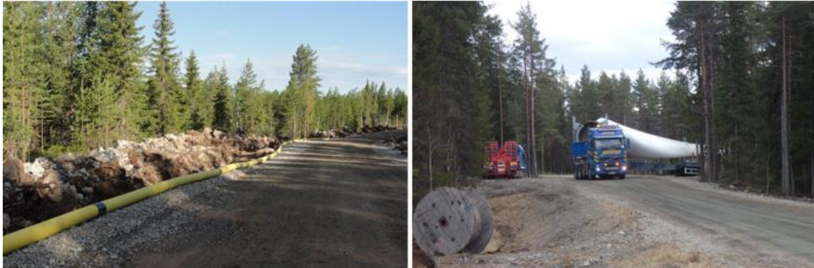
Kuva 4.8 Vasemmallä esimerkki tuulivoimapuiston rakennus- ja huoltotiestä. Oikealla tuulivoimalan osia kuljetetaan erikoiskuljetuksina (FCG Finnish Consulting Group Oy).
