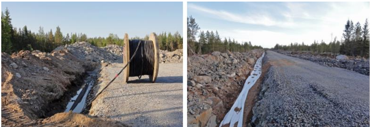
Kuva 4.13 Maakaapelit upotetaan huoltoteiden yhteyteen (FCG Finnish Consulting Group Oy).
