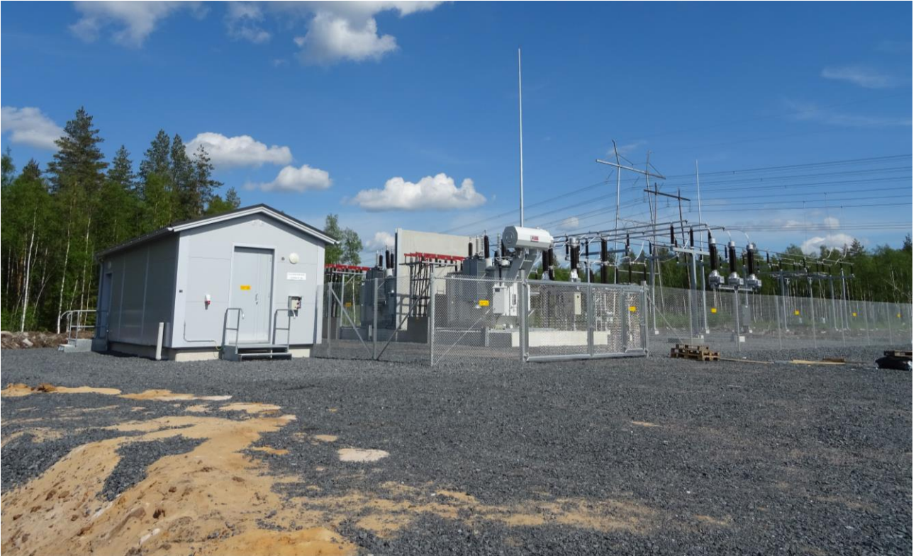
Kuva 15. Esimerkki tuulivoimapuiston sähköasemasta (Oltava, Pyhäjoki) (Kuva: Sweco Finland Oy).
