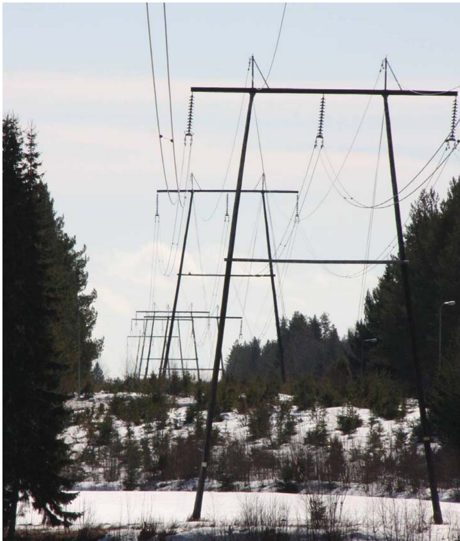
Kuva 8.5 Tyypilliset 220 kV voimajohdon pylväät johtoineen. (Kuva: Marko Väyrynen)
