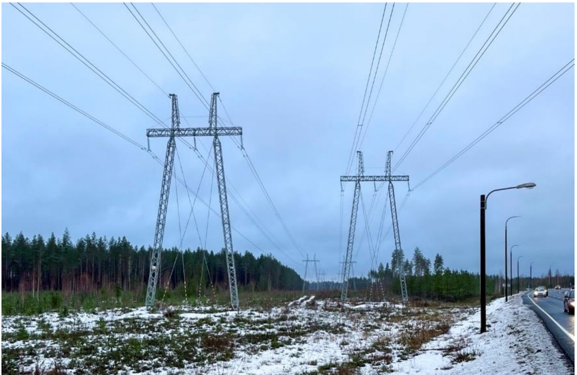
Kuva 4.11 Kaksi 110 kV linjaa samassa johtokäytävässä Kontiolahden Uurossa. Kuvassa näkyvät 110 kV Kontiolahti-Kaltimo ja Kontiolahti-Uimaharju-linjat. Kuva: Sitowise Oy.
