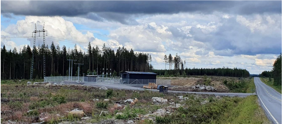
Kuva 4.7. Esimerkkikuva 110 kV sähköasemasta. Kuva: Timo Huhtinen.
