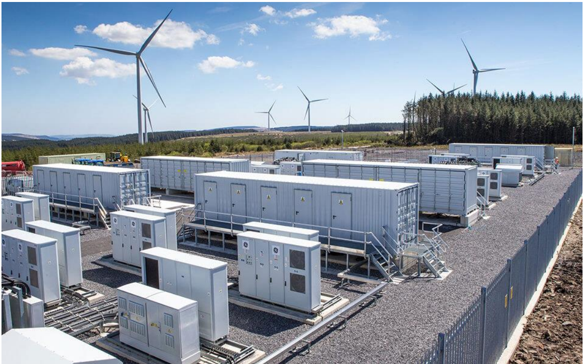
Kuva 4.8 akkukenttä. Kuva: Vattenfall.
