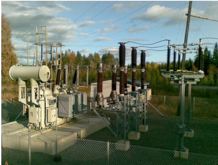
Kuva 3-7. Esimerkki tuulivoimapuiston 20/110 kV sähköasemasta. (kuva: Pöyry)
