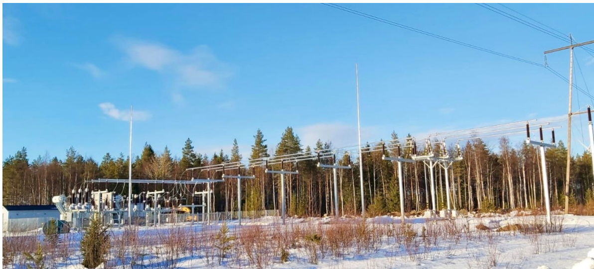
Kuva 3-3. Tuulivoimapuiston sähköasema. Kuva: © ELTEL Networks Oy.
