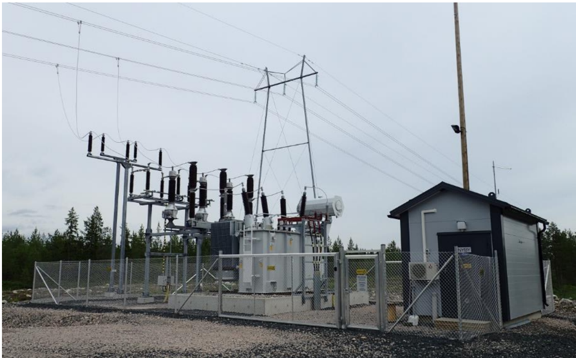
Kuva 32. Esimerkki tuulivoimapuiston sähköasemasta.
