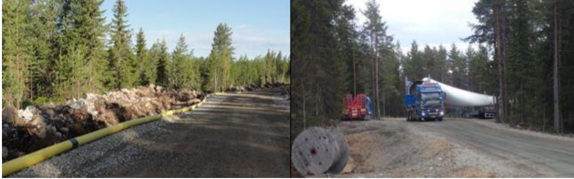
Vasemmalla esimerkki tuulivoimapuiston rakennus- ja huoltotiestä. Oikealla tuulivoimalan osia kuljetetaan erikoiskuljetuksina (kuva: FCG).
