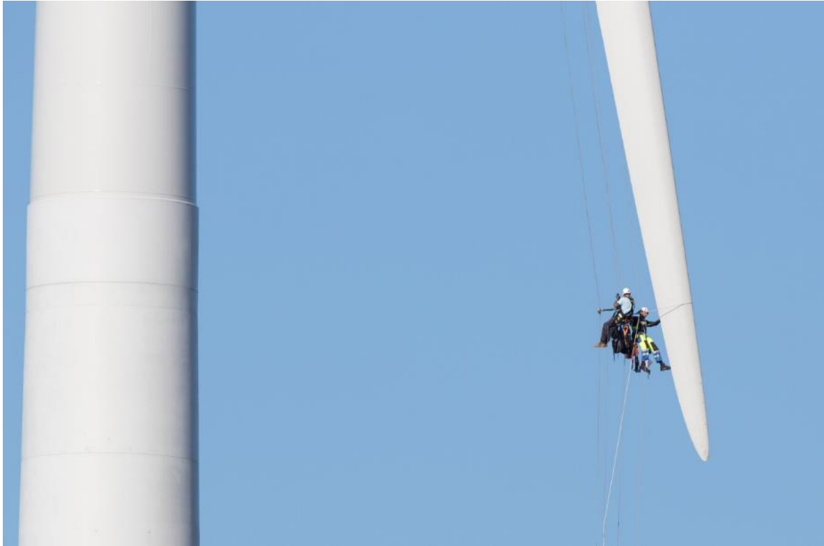
Kuva 41. Tuulivoimalan huoltotoimenpiteitä (kuva: FCG).
