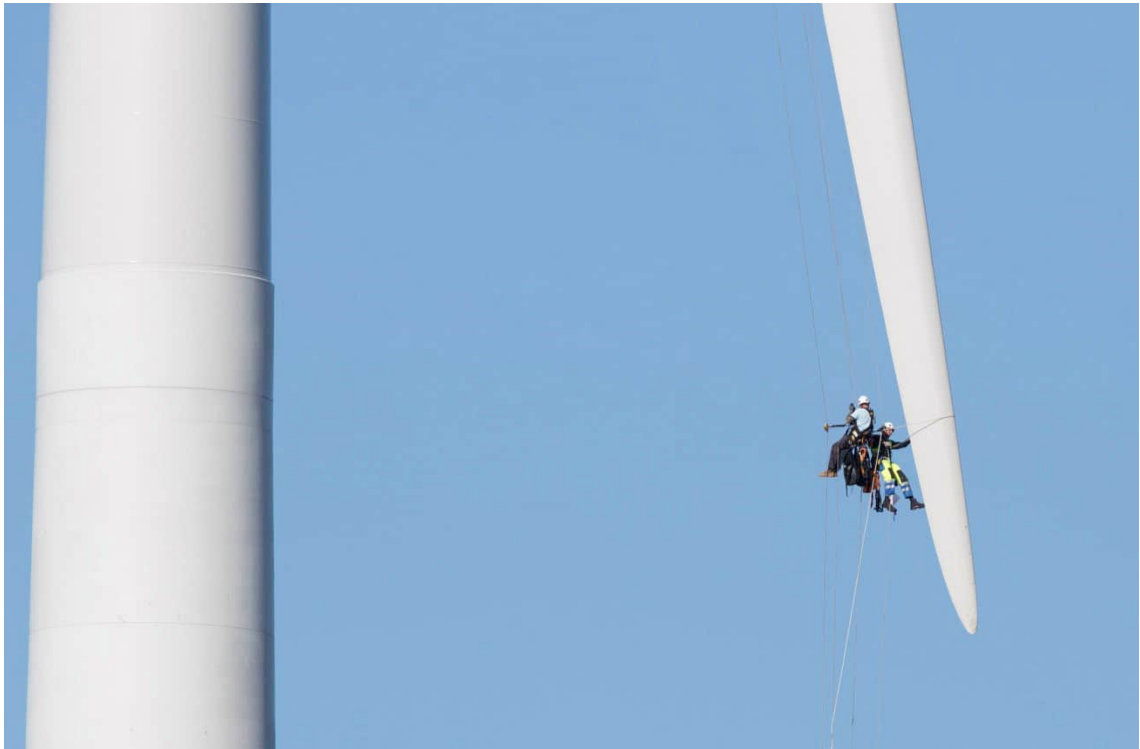
Kuva 4.20. Tuulivoimalan huoltotoimenpiteitä. (Kuva: FCG).
