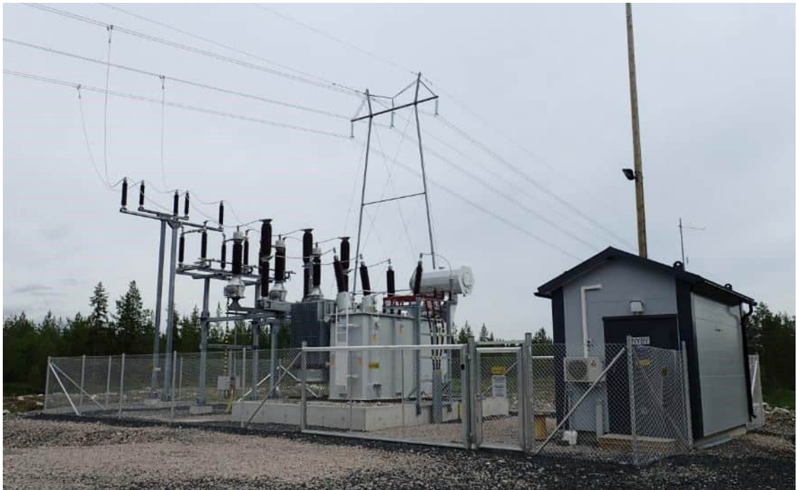
Kuva 4.9. Esimerkki tuulivoimapuiston sähköasemasta 110 kV. (Kuva: FCG).
