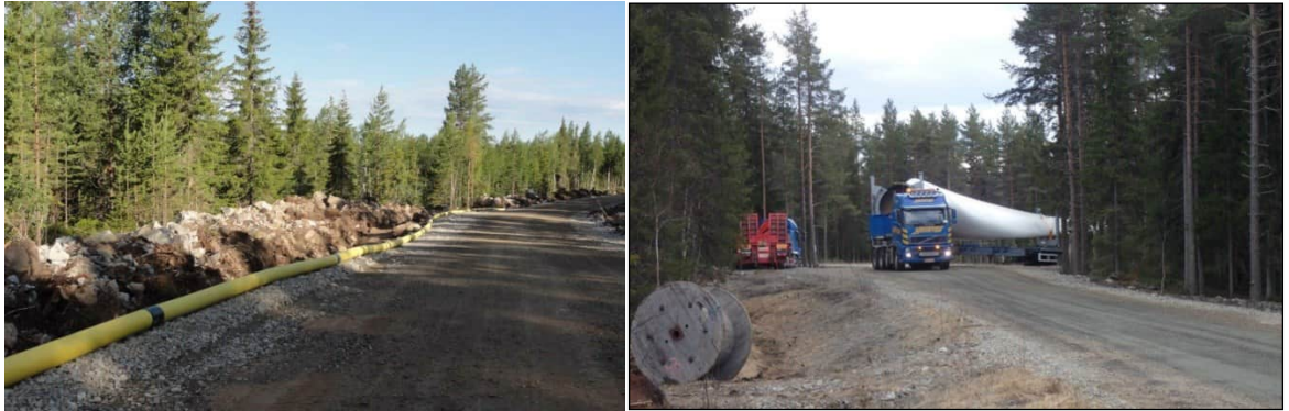
Kuva 4.8. (Vasemmalla) Esimerkki tuulivoimapuiston rakennus- ja huoltotiestä. Teitä käytetään muun muassa betonin, soran ja voimaloiden komponenttien kuljetuksiin sekä tuulivoimapuiston käyttövaiheessa huoltoajoihin. Maakaapeli sijoitetaan ojakaivavantoon tien reuna-alueelle. (Oikealla) Tuulivoimalan osia kuljetetaan erikoiskuljetuksina. (Kuvat: FCG).
