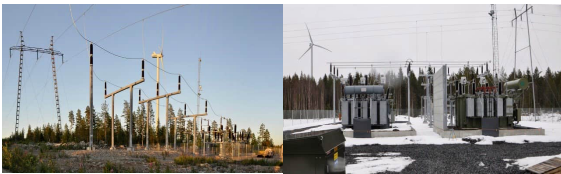
Kuva 4.16. Esimerkkikuvia tuulivoimapuiston 110/20 kV sähköasemasta (Kuva: Leila Väyrynen/FCG).
