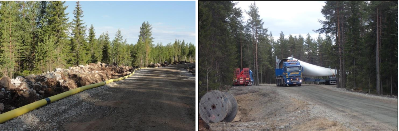
Kuva 5.6. (Vasemmalla) Esimerkki tuulivoimapuiston rakennus- ja huoltotiestä. Teitä käytetään muun muassa betonin, soran ja voimaloiden komponenttien kuljetuksiin sekä tuulivoimapuiston käyttövaiheessa huoltoajoihin. Maakaapeli sijoitetaan ojakaivantoon tien reuna-alueelle. (Oikealla) Tuulivoimalan osia kuljetetaan erikoiskuljetuksina. (Kuvat: FCG).
