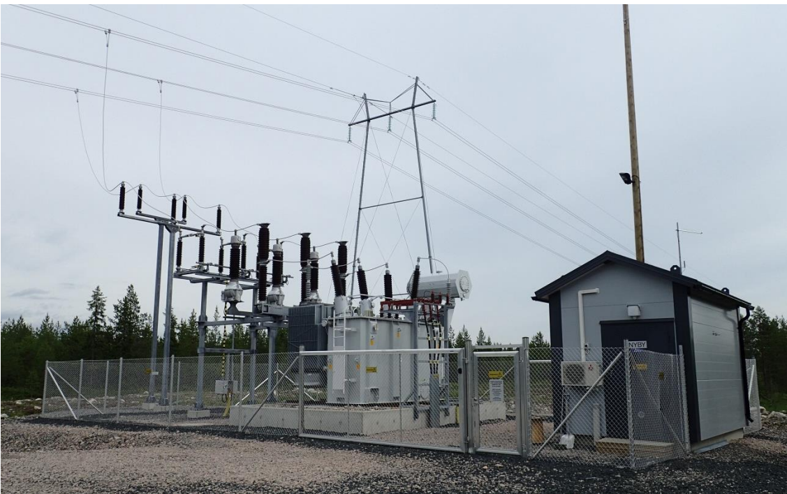
Kuva 5.7. Esimerkki tuulivoimapuiston sähköasemasta (kuva FCG).
