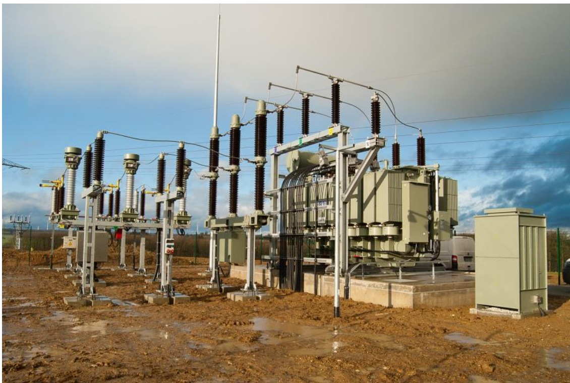
Kuva 2-7. Esimerkkikuva tuulivoimapuiston sähköasemasta.
