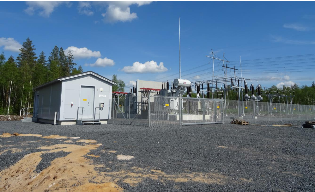
Kuva 18. Esimerkki tuulivoimapuiston sähköasemasta (Oltava, Pyhäjoki) (Kuva: Sweco Finland Oy).
