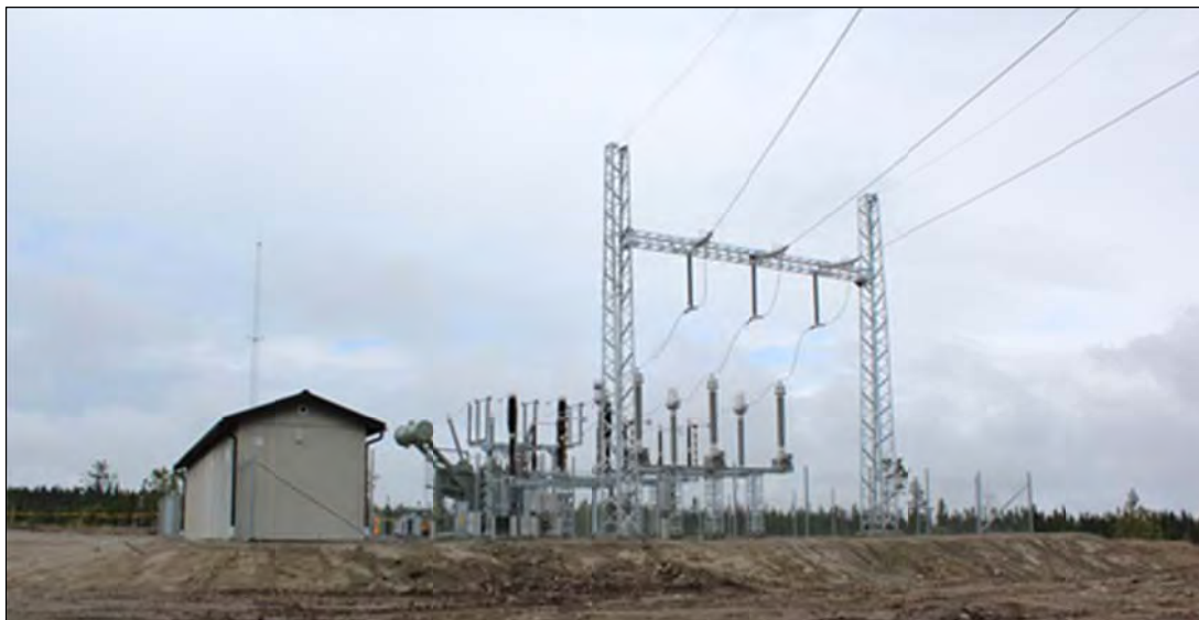
Figur 3.8. De mest synliga komponenterna vid elstationen är en skyddsbyggnad, ställverk, åskledare och ett transformatorrum (foto: Hans Vadbäck).
